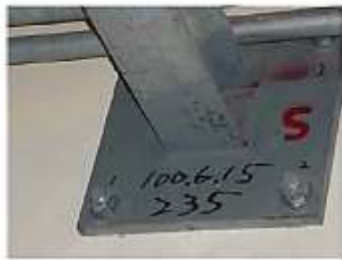
照片 7: 2BSW7H 系室 SMP 螺栓違規情形
