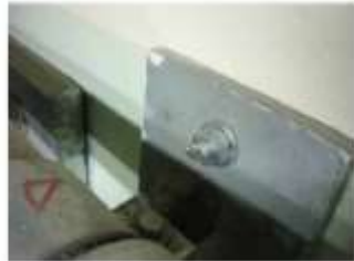
照片 9: 一號機房 435 房間安全櫃導線管支撐架 SMP 螺栓違規情形
