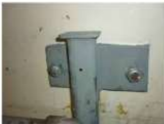
照片 10: 一號機房 447 房間 1P52-GUTD-002392 室 SMP 螺栓違規情形
