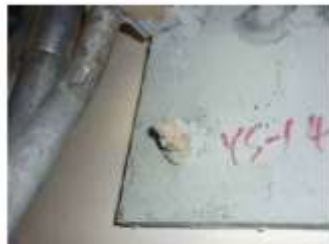
照片 12: 螺栓墊片螺帽端情形
